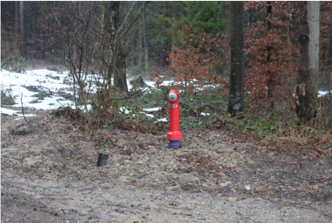
Ein Männlein steht im Walde: Der neue Hydrant für die Löschwasserversorgung
